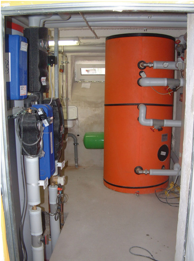
Heizzentrale mit Warmwasserspeicher
