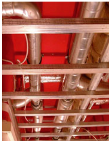
Lüftungs- und Heizleitungen unter Flurdecke
