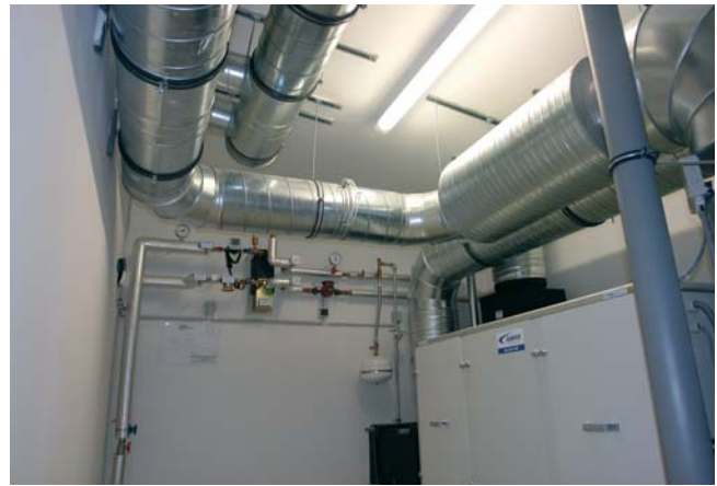
Lüftungszentrale für 15 Wohnungen
