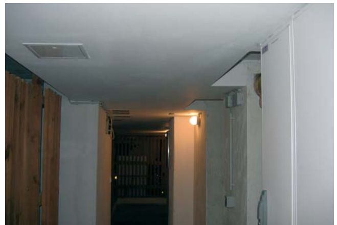
Dämmung der Kellerdecke – die Versorgungsleitungen werden innerhalb der Dämmung im Gangbereich geführt mit der Folge geringerer Leitungswärmeverluste
