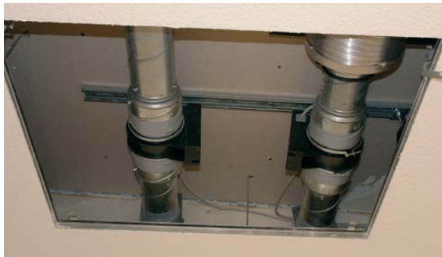
Der Volumenstromregler wird durch das Umschalten des Regelungstasters durch den Nutzer betätigt
