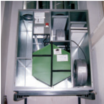
Lüftungsgerät für eine Wohneinheit.
