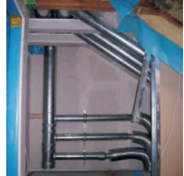
Verteilung: direkter Anschluss der Schalldämpfer an die Brandschutzklappen.
