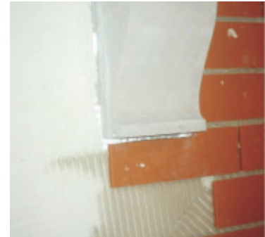
Wärmedämmverbundsystem getarnt als historisches Backsteinmauerwerk.
