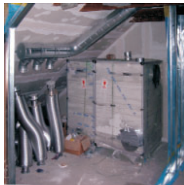
Lüftungszentrale auf kleinstem Raum; flexible Schalldämpfer direkt vor dem Deckenschott zur Wohnung.
