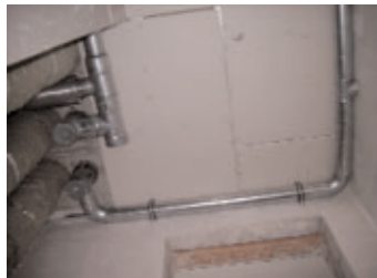
Zulufileitung im Flur vor der Verkleidung mit Gipskarton – nach der Verkleidung: Bild S. 45.
