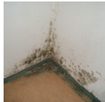
Schimmel in einem Gebäude mit 6 cm Dämmung in einer Außenecke hinter einem Schrank.
