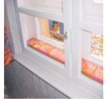
Mieterselbsthilfe gegen zugige Fenster im Winter.
