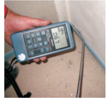
Fehlerquellen beim Estrich: Lecks in Decke, Innenputz, Fenster-Verklebungen und Durchbrüchen.
