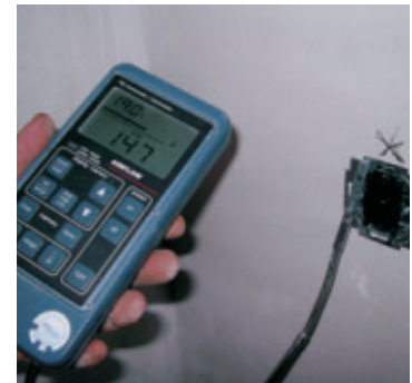
Gebäudetechnik: Lecks an Elektro-lehrrohren und -Unterputzdosen sowie Durchbrüchen von Leitungen.
