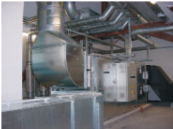
Zentrale der Zu-/Abluftanlage.
