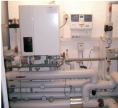
Gas-Brennwert-Anlage für ein energieeffizientes Mehrfamilienhaus.
