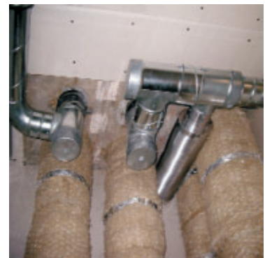
Steigstrang mit Abzweig von Zu- und Abluftleitung für eine Wohnung.
