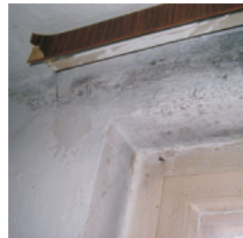
Schimmelpilzbildung hinter einem Vorhang aufgrund zu niedriger Oberflächentemperaturen.
