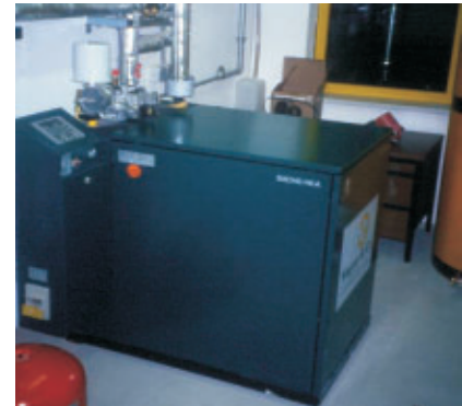
Günstig für den Anlagenaufwand: Einsatz von Kraft-Wärme-Kopplung.
