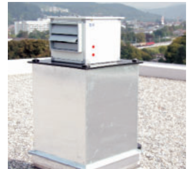
Abluftventilator für einen Steigstrang als Zentralgerät auf dem Dach mit Schalldämpfer im Sockel.
