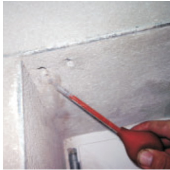
Innenputz als luftdichtende Schicht: besonders anfällig bei porositärem und gelochtem Mauerwerk.
