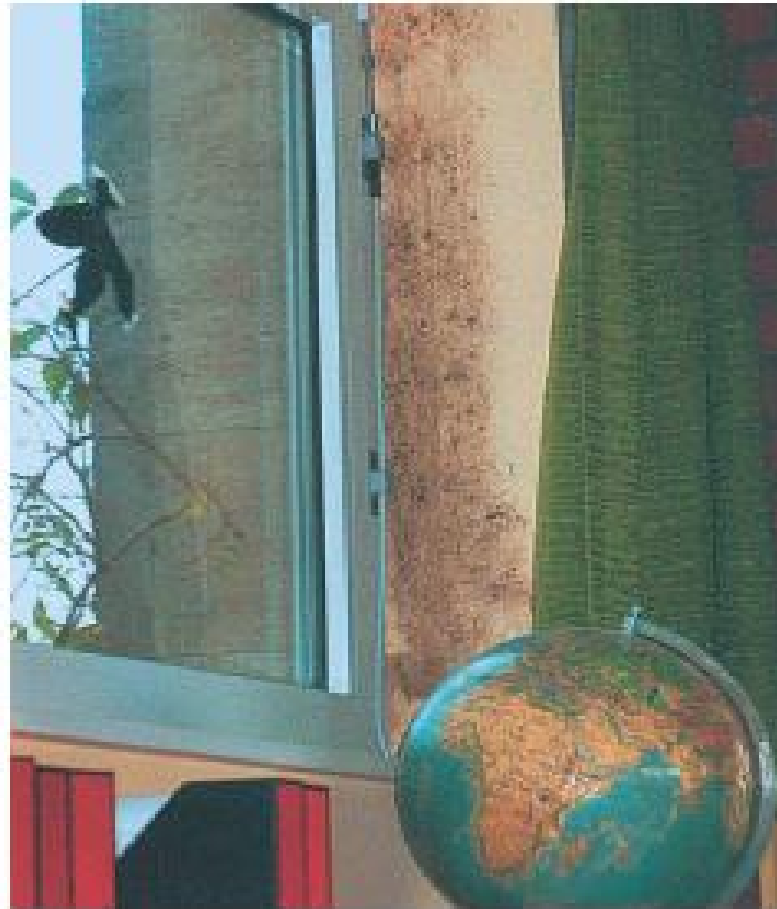
Schimmelbildung vor der Sanierung
